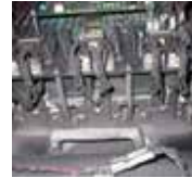
传统UPS内部积灰状态
